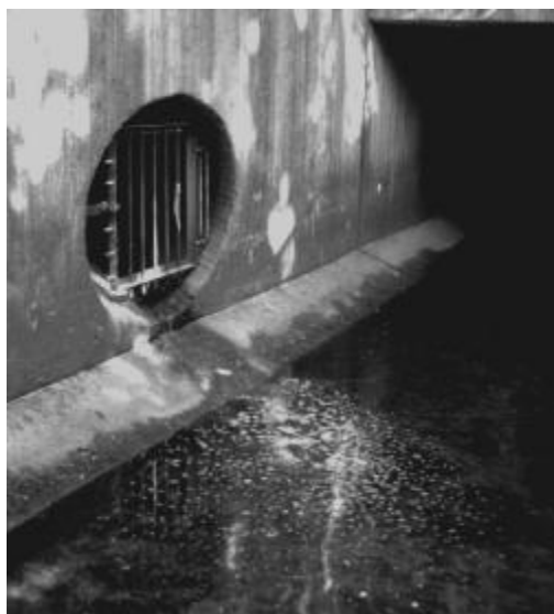
Bild 2: Ausgeschüttetes Putzwasser hat in Niedrigwassersituationen unmittelbare Schädigung. – Der Durchmesser des Zulaufs läßt die hydraulische Situation beim Starkregeneignis erahnen.
